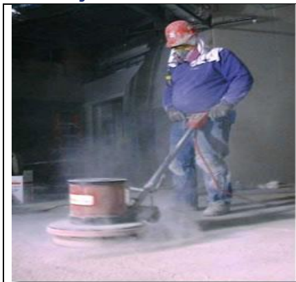
Slechte praktijk – polijsten van betonvloer zonder afzuiging op het gereedschap (AD TWW, B)
