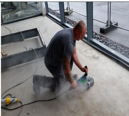
Slechte praktijk – Gebruik van een betonfrees zonder afzuiging op het gereedschap (HSA, IE)
