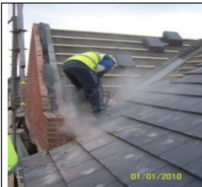
Slechte praktijk – Dakpannen doorslijpen zonder beheersmaatregelen (National Federation of Roofing Contractors Ltd., GB)
