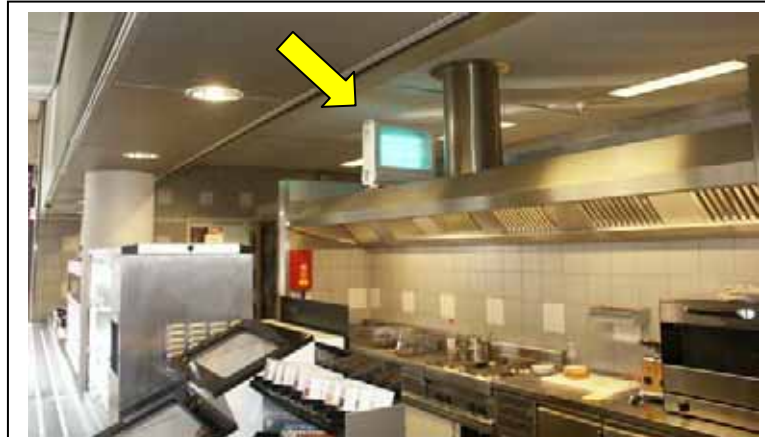
Figuur 35 Typische horeca-situatie met gesloten UVC-luchtdesinfectie. De lucht wordt door een ventilator langs de UVC-lampen geblazen, alleen het “nevenprodukt” zichtbaar blauw licht en wat verwaarloosbaar UVA treedt uit. De gebruiker loopt bij een intacte behuizing geen enkel risico.
